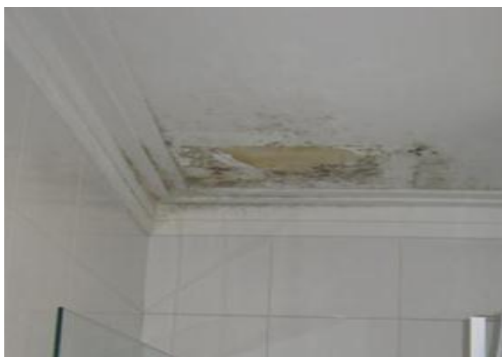
Figura 4 – Registro de infiltração no forro do banheiro
