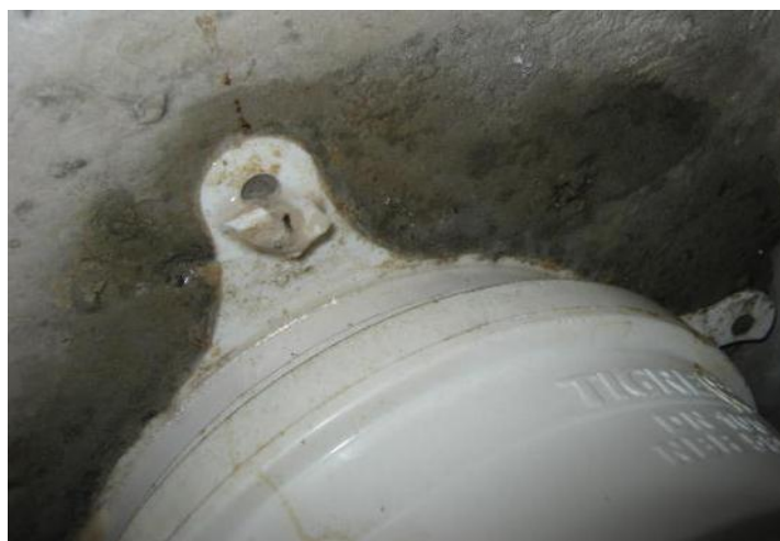
Figura 5 – Registro de infiltração no teto do banheiro após a remoção de parte do forro
