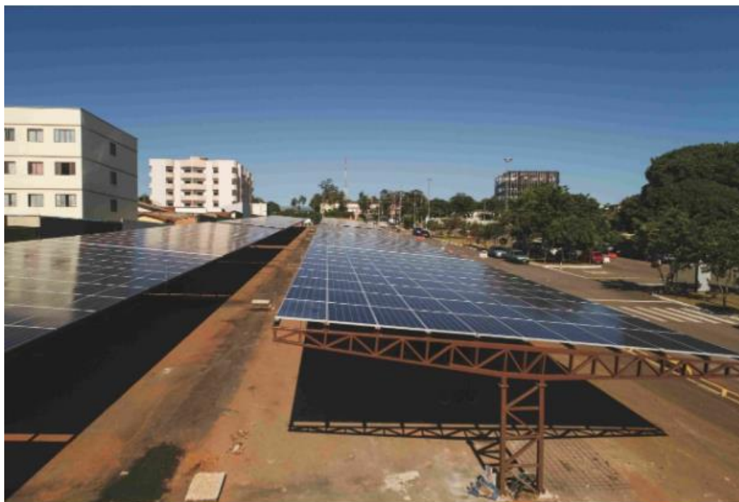
Figura 8 – Inclinação de, aproximadamente, 10° na instalação
