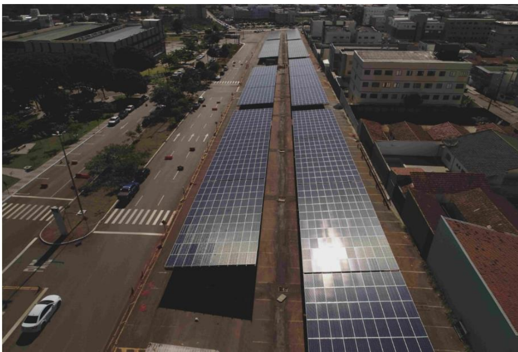
Figura 7 – Placas fotovoltaicas instaladas na instituição
