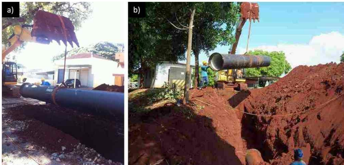
a) Tubulação com cinta de içamento; b) Funcionário guiando tubulação para assentamento em vala.
