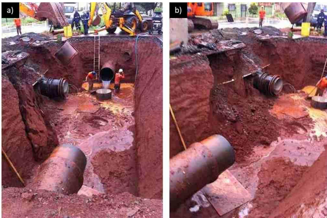
a) Ruptura por cisalhamento do solo saturado; b) Solo saturado desmoronado.
