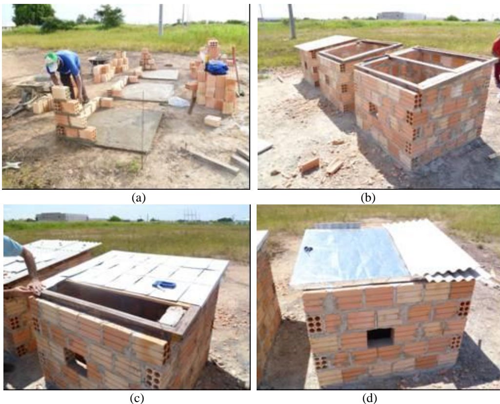
Figura 3 - Construção dos protótipos: a) execução das paredes de vedações; b) estrutura do telhado; c) montagem do sistema de isolamento térmico com embalagens Tetra Pak; d) efetivação do sistema de isolamento térmico com manta industrializada e cobertura com telhas de fibrocimento.
